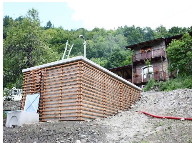
Vasca della b.ta Bocchiardo a servizio b.ta Rey
