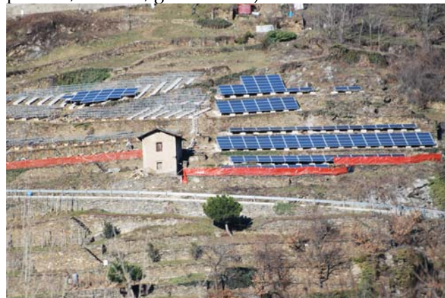
Impianto fotovoltaico terrazzamenti
